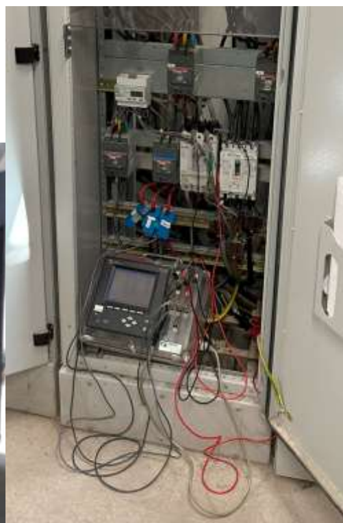
TGD – Conectare Echipamente de Monitorizare
